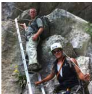
Échelle et câbles installés
